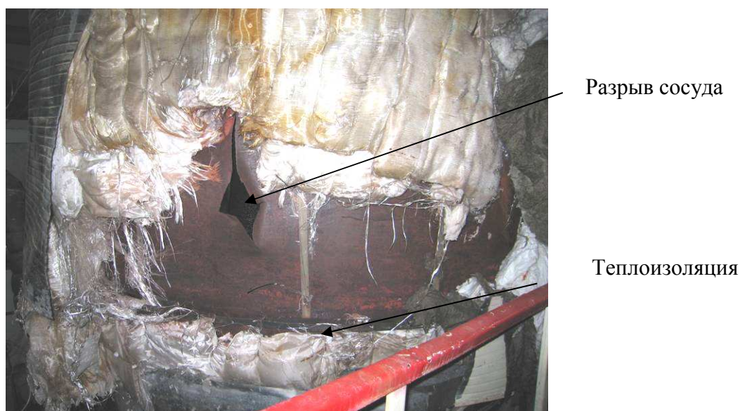
Рис. Л32.3. Результаты наблюдения коррозионного повреждения сосуда давления на Смоленской АЭС
