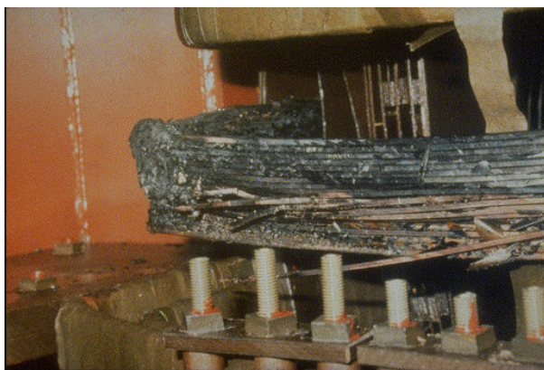
Рис. 3.4. Сгоревшая обмотка трансформатора гидроэлектростанции в Квебеке. Это сделала космическая плазма!
